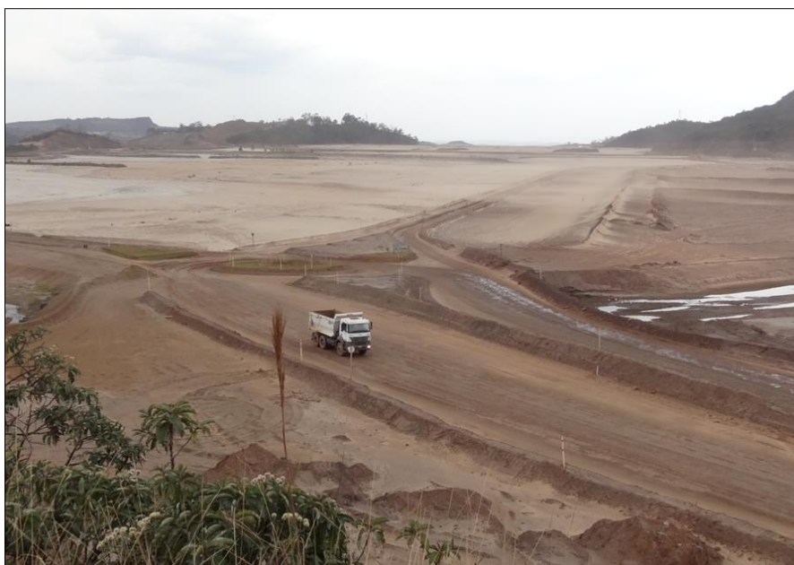
Figura 5.19 - Diques auxiliares no setor D.
