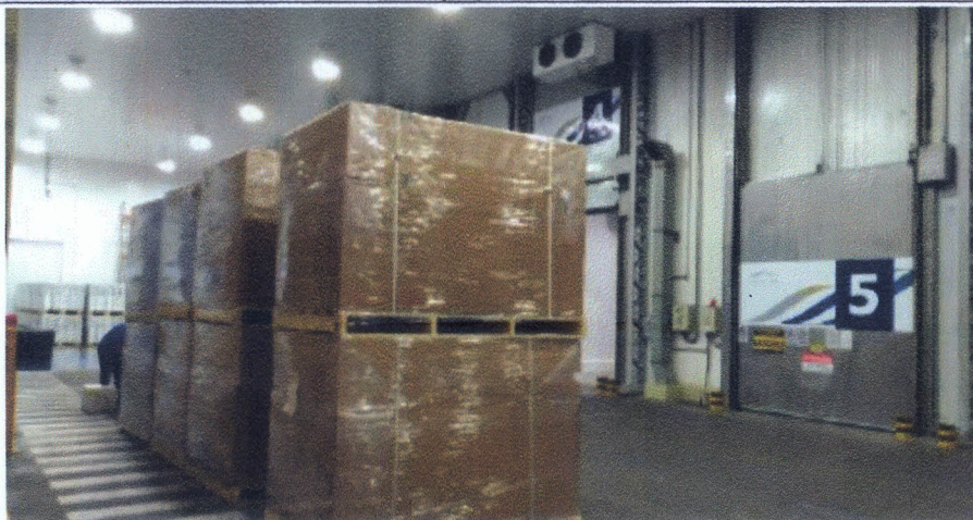
Área refrigerada do Terminal
