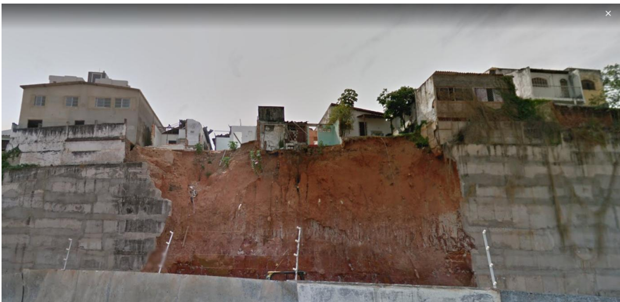
Figura 1: Talude exposto após queda de muro de contenção, Comunidade do Jacó.
