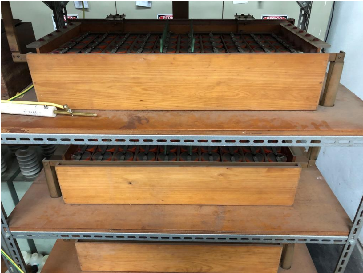
Figura 4.5a Banco de Capacitores para geração do campo magnético Fonte: Autor
