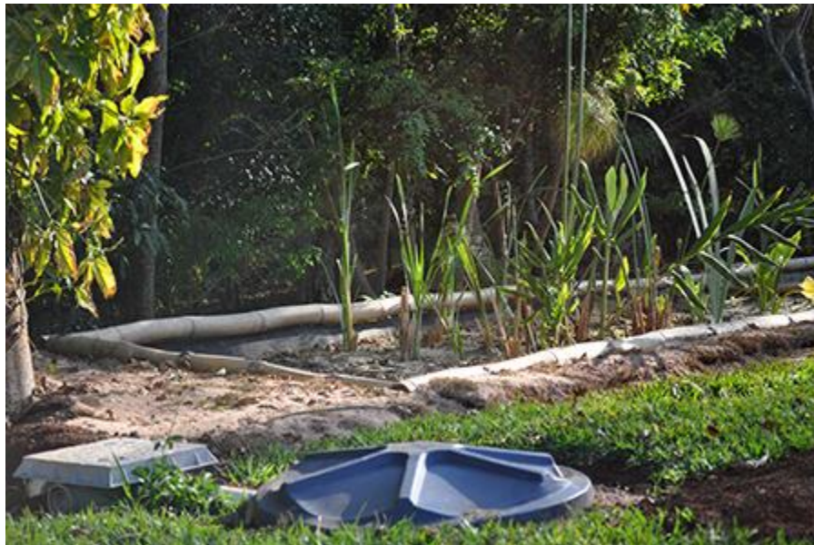
Jardim Filtrante instalado em São Carlos, em setembro de 2013
