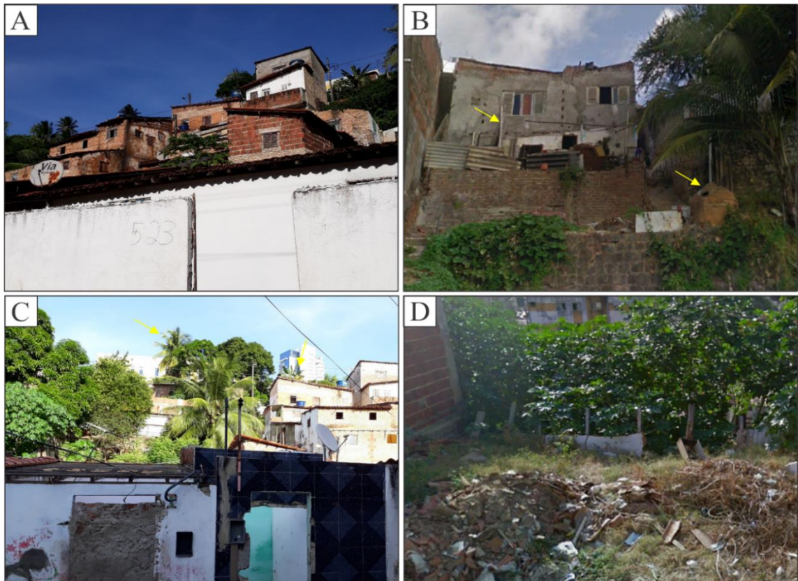
Figura 5.2: Fatores antrópicos que facilitam a desestabilização dos taludes. Em (A) concentração habitacional ao longo da encosta, (B) encanamentos e fossa séptica indevidamente instalados, indicados pelas setas amarelas, (C) árvores de grande porte cultivadas no substrato inclinado, com destaque a coqueiro e bananeira, evidenciados por setas amarelas e em (D) encosta com descarte de resíduos sólidos. Todas essas situações comprometem a coesão do solo e assim favorecem a deflagração de movimentos de massa.
