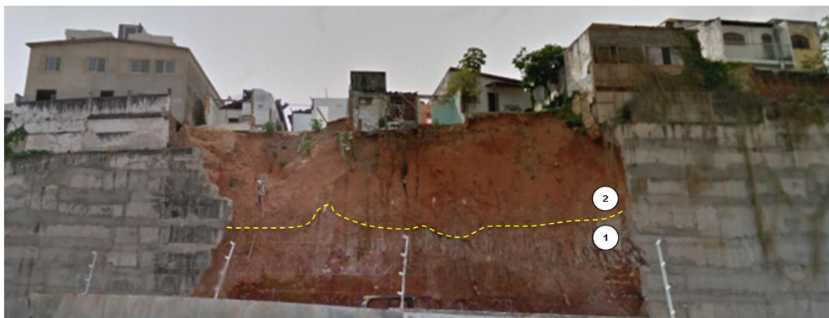
Figura 5.1: Fotografia expondo os materiais inconsolidados residuais das formações Barreiras em (1) e Potengi em (2), justamente no setor da comunidade em que houve um corte de talude realizado de maneira errônea que favoreceu o tombamento de um muro de arrimo.
