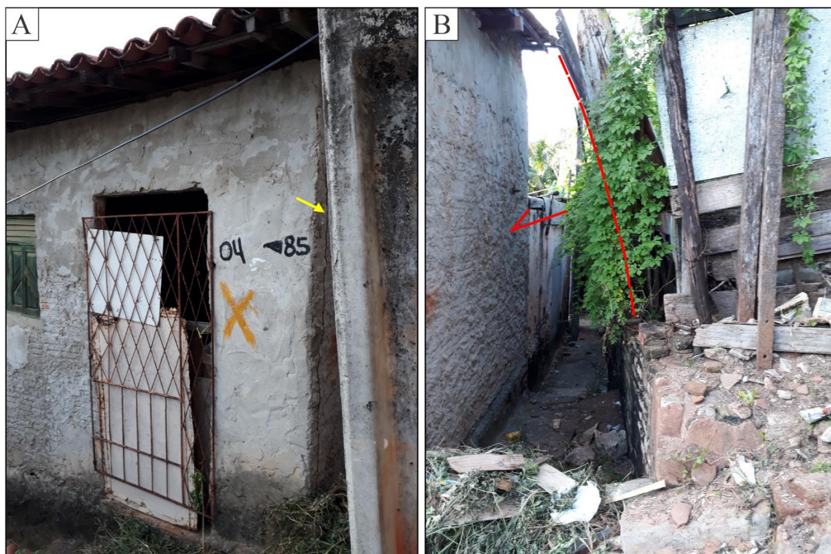
Figura 5.4: Feições de instabilidade da encosta, em (A) trincas em uma habitação de baixa infraestrutura, indicada pela seta amarela, e em (B) embarrigamento do muro de contenção construído por materiais inadequados, observar em vermelho a inclinação da obra diante da instabilidade do talude e a ausência de contrapesos na porção inferior da estrutura.
