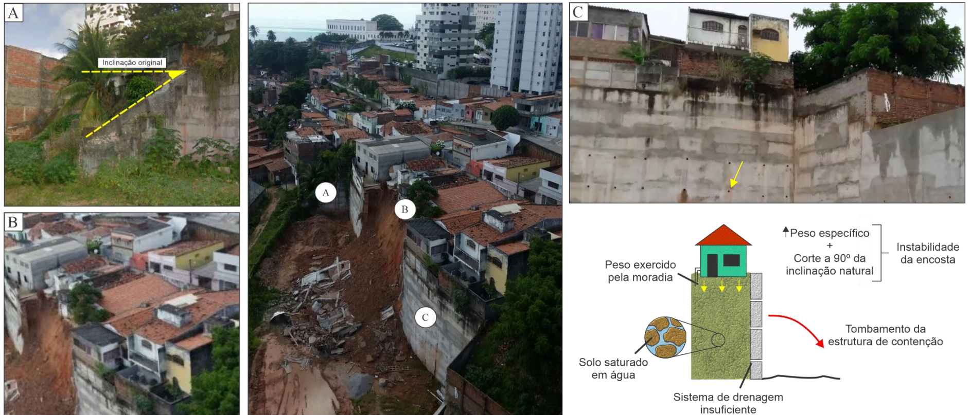
Figura 5.3: Visão geral do colapso do muro de arrimo da Comunidade São José do Jacó. Em (A) observa-se a inclinação original aparente do talude que posteriormente passou por um corte a 90°, em (B) a ampla quantidade de habitações situadas sobre o substrato associado ao fenômeno e em (C) os furos realizados para o escape das águas concentradas no solo. Não obstante, ainda pode-se analisar o esquema montado para explicar o movimento de massa em questão, em que o corte feito sem a devida infraestrutura (tirantes e/ou sobrepeso na porção inferior do muro) em junção com o aumento do peso específico do litotipo do setor causado pela massa das moradias e da água concentrada nos poros geraram consequentemente o tombamento da obra indevidamente realizada (Fonte: Blog do BG, 2016).
