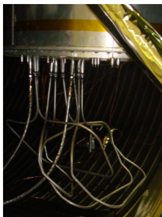
Figura 3.4 - Detalhe dos tubos de aço inox que conectam os estágios do MNP.
