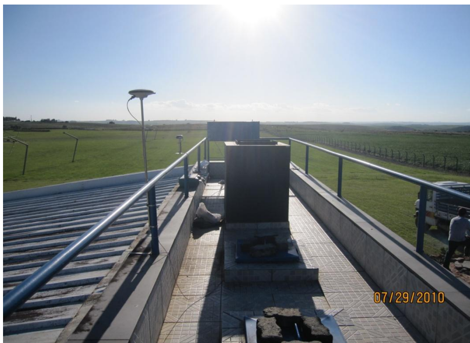
Figura 4.4 – Equipamento instalado no Observatório Espacial do Sul – OES/CRS/INPE - MCT –, em São Martinho da Serra, RS - Imagem externa do equipamento.
