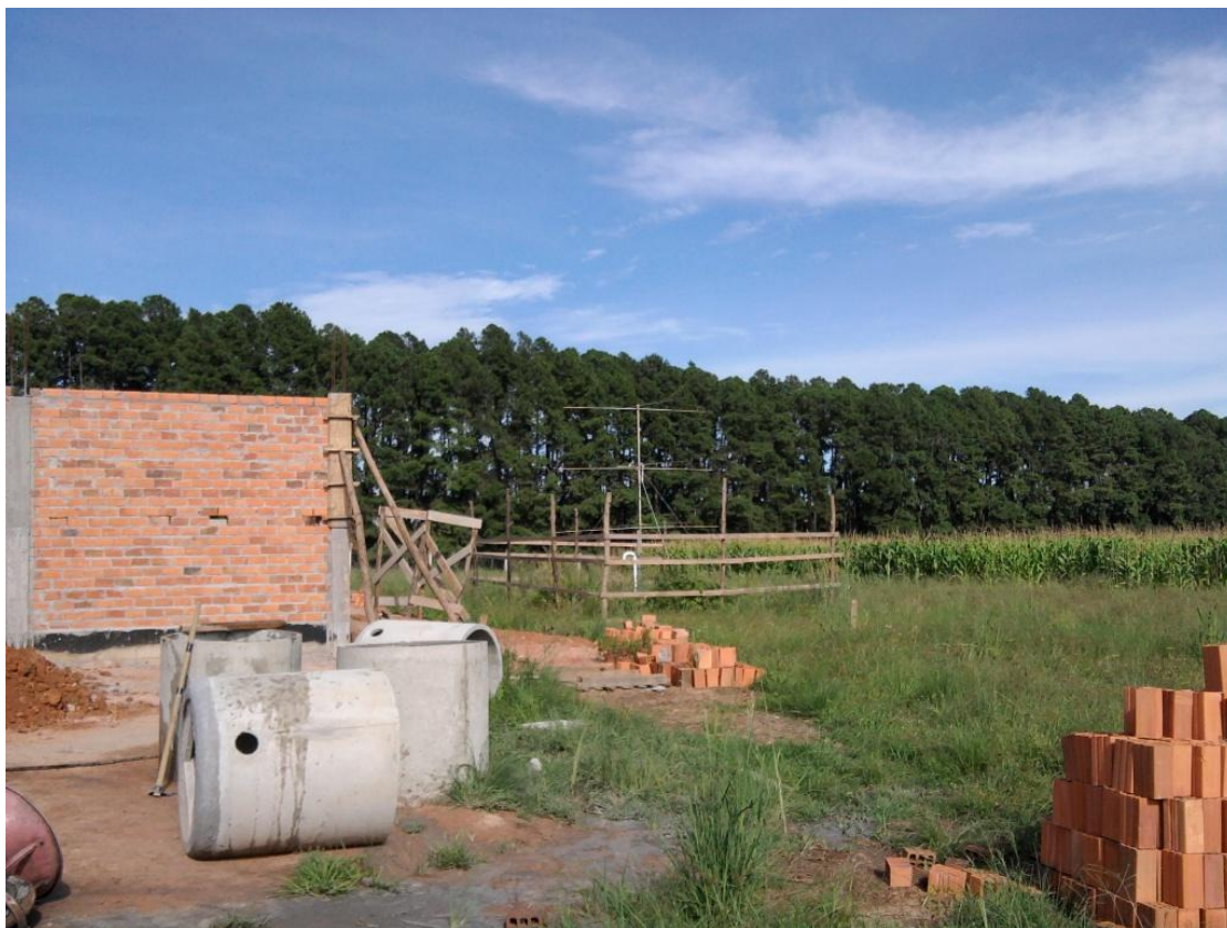
Figura 20 - Modificações ocorridas na área de instalação do radar. Do lado direito da foto se encontra a antena transmissora. Fonte: Banco de dados do laboratório.
