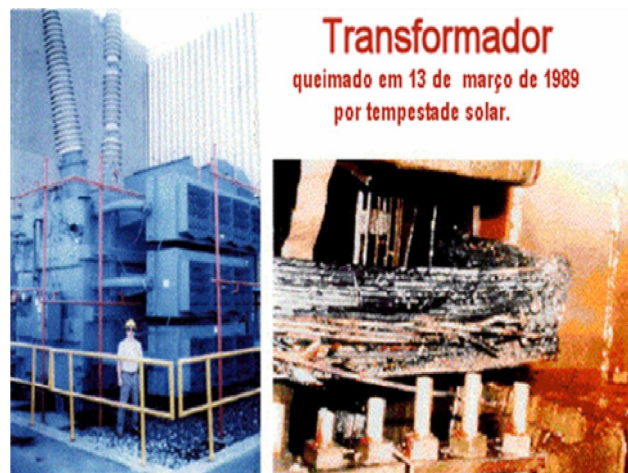
FIGURA 22: Transformador destruído, devido a uma tempestade geomagnética em Quebec no Canadá.
