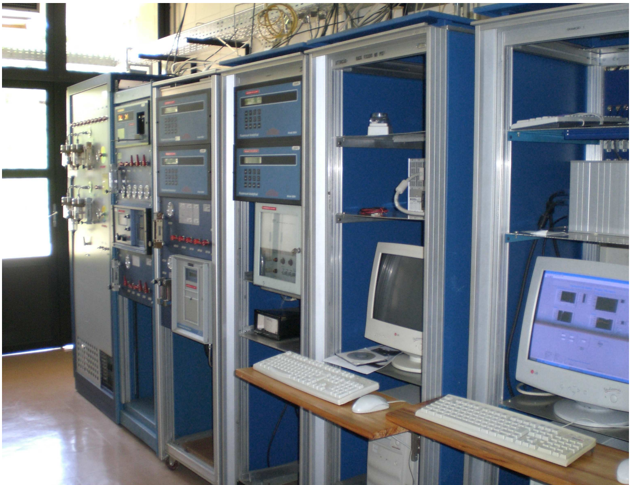
Figura 4 – Vista Geral dos Analisadores dos Gases \text{CO}_2 , \text{CO} , \text{NO}_x e UHC.
