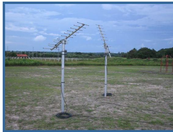
FIGURA 7.1 - Antenas do tipo Yagi do Sistema VHF, instaladas no Observatório Espacial de São Luis – OESLZ/INPE – MCT, São Luis-MA.
