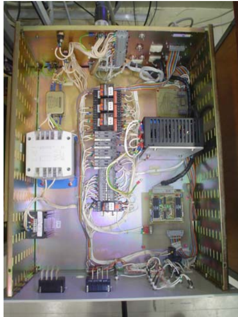
Figura 9: Vista superior do módulo de comando.
