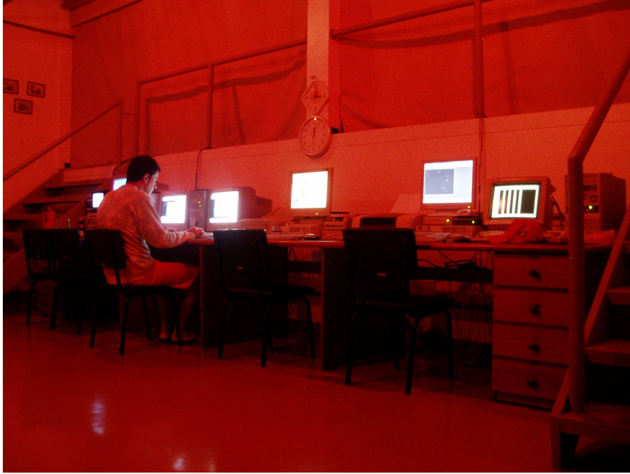
FIGURA 2-13: Central de controle instalado no Observatório Espacial do Sul – OES/CRSPE/INPE - MCT, no Prédio 5, em São Martinho da Serra.
