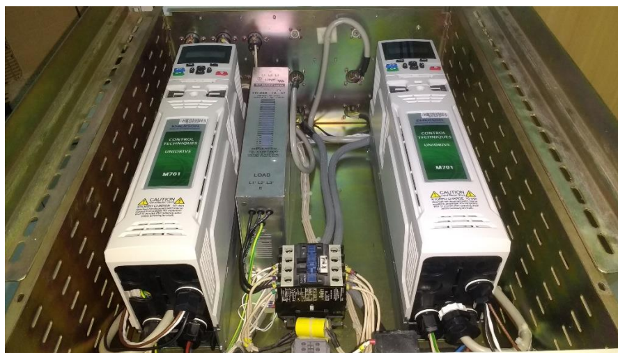
Figura 73. Drives instalados na Unidade de Potência
