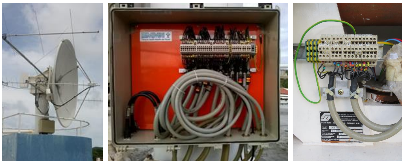
Figura 110. Caixa de Passagem Externa
