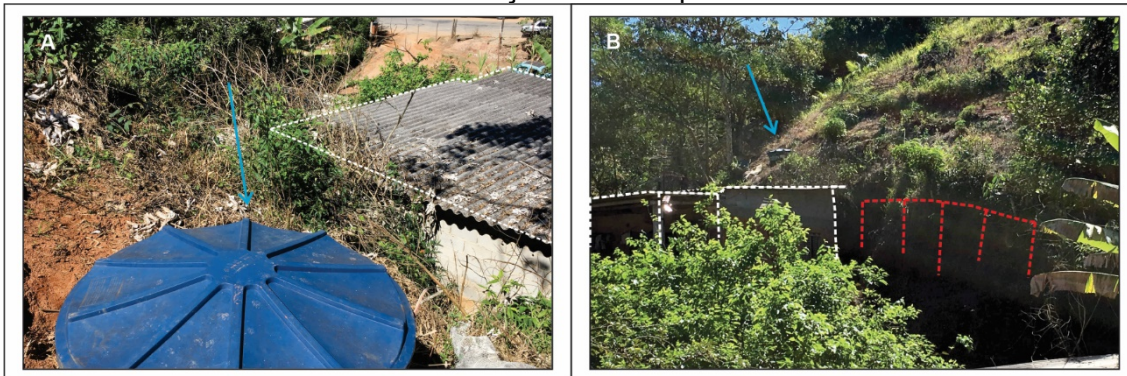
Figura 5.13 – Imagens da Encosta 55 com destaque para a caixa d'água em topo de talude de corte e edificação de baixo padrão construtivo.
