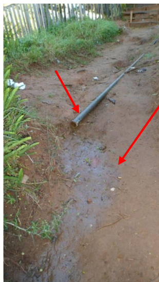
Figura 2.8. Exemplo de encanamento a céu aberto e solo saturado.
