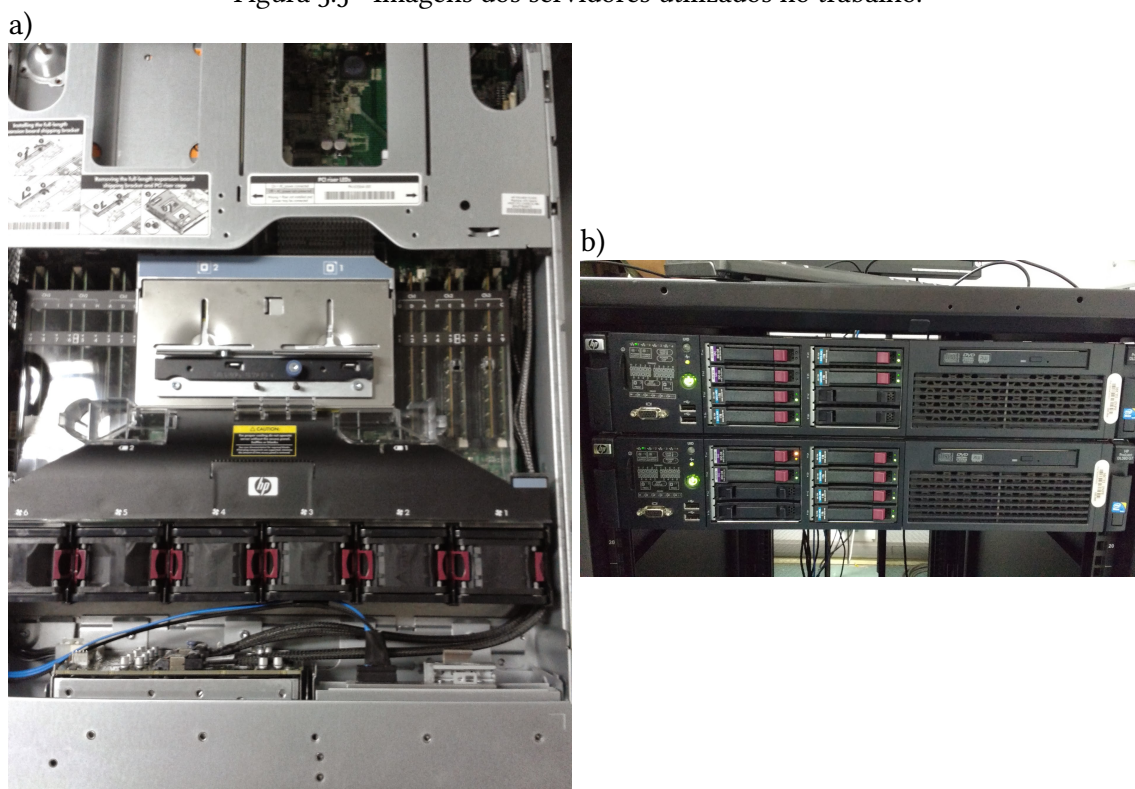
Figura 3.5 - Imagens dos servidores utilizados no trabalho.
