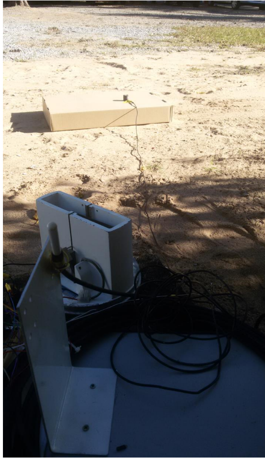
Figura 14- Datalogger sendo testado em campo.
