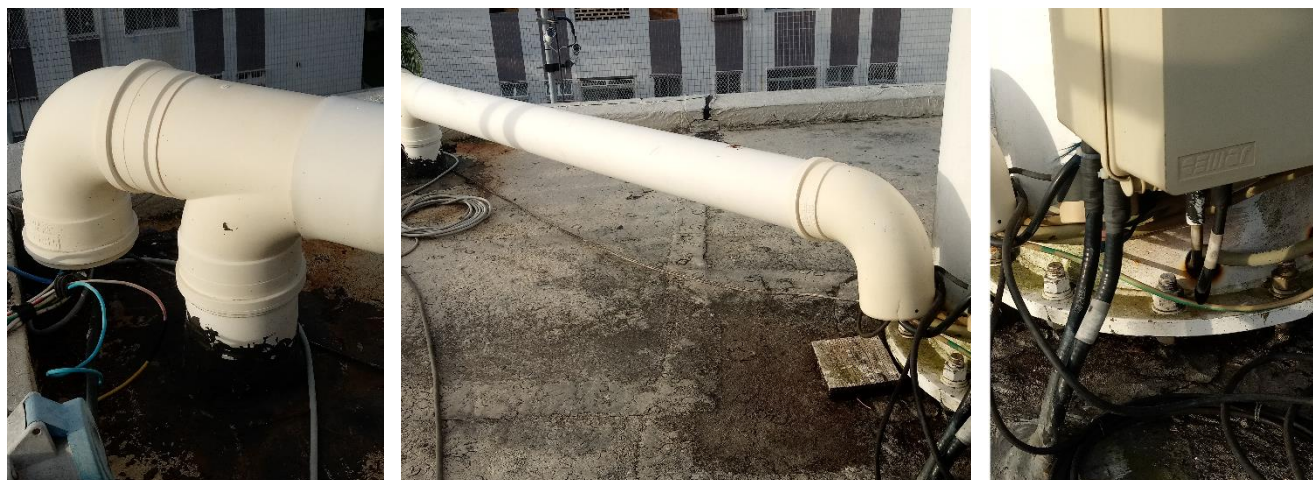
Figura 109. Trajetos dos Cabos no Exterior da Estação
