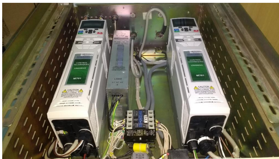
Figura 73. Drives instalados na Unidade de Potência
