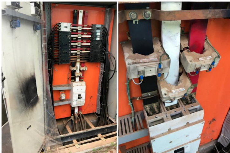
Figura 2.29 – Circuito de distribuição de energia danificado por raio.
