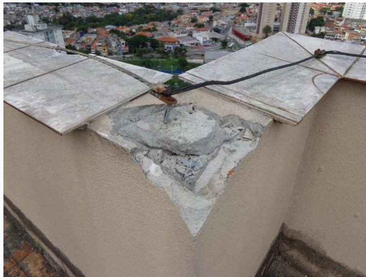
Figura 2.27 – Exemplo de ruptura no concreto por expansão da água acumulada nas fissuras.
