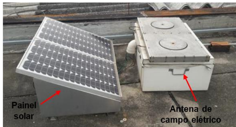
Figura 3.9 – Antena de campo elétrico utilizada.
