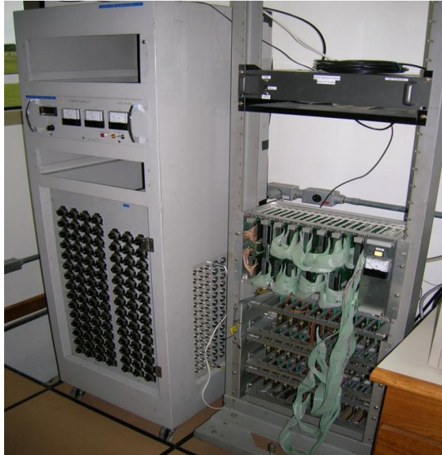
Figura 21 – Racks que suportam os potenciômetros, sistemas de processamento de dados e fontes de baixa e alta tensão.
