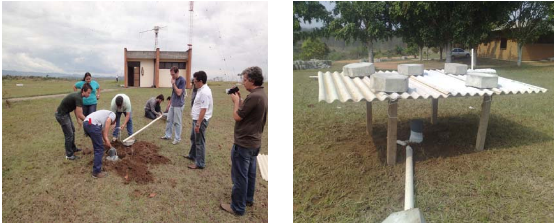
Figura 16: (à esquerda) Equipe instalando o magnetômetro na sede do INPE de Cachoeira Paulista e (à direita) o equipamento instalado.
