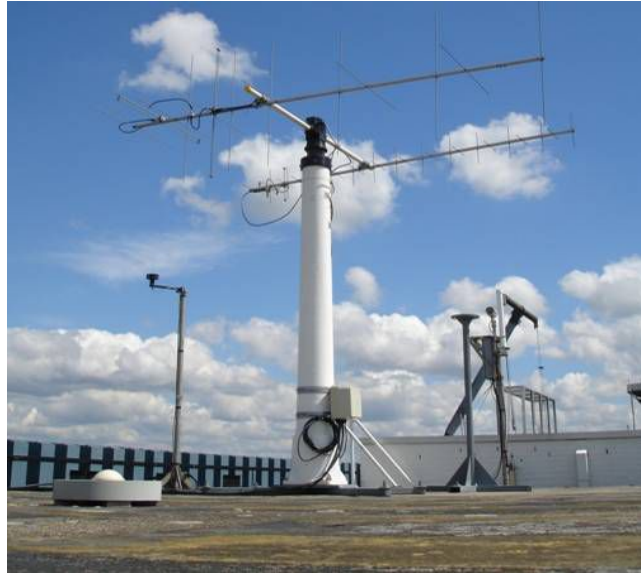
Figura 4.9 - Antenas UHF e VHF montadas sobre um posicionador no telhado do prédio mais alto em Delft, Holanda.
