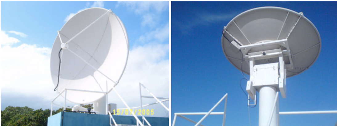
Figura 3: Antena Parabólica da EMMN vista de ângulos diferentes
