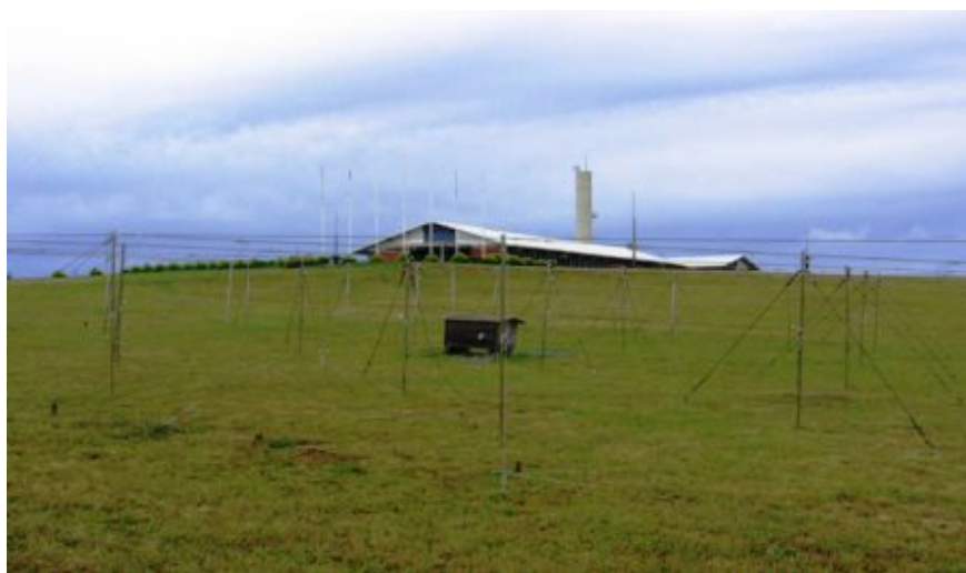
Figura 4.8: Antenas dipolos 4 x 4 instalados e em operação no Observatório Espacial do Sul – OES/CRS/CIE/INPE – MCT em São Martinho da Serra, RS.
