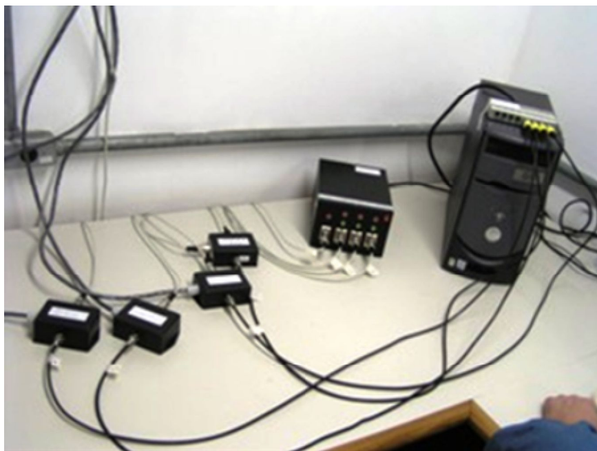
Figura 4.14: Parte do sistema de cabos, pré-amplificadores, fonte, computador e da placa de som Delta44 do sistema de aquisição de dados da estação de recepção SAVNET do Observatório Espacial do Sul, em São Martinho da Serra, RS.
