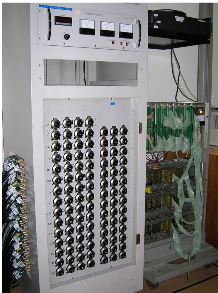
Figura 3.5 – Fontes de alimentação e sistema de processamento de sinais do telescópio detector de muons.
